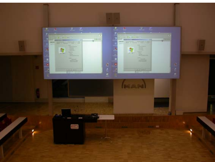
All in One. Ob Bild, Ton, Licht oder Mikrophon, das von Panatronic audiovisuell ausgestattete AUDIMAX der FH Steyr ist für Veranstaltung mit den vielseitigsten Anforderungen gerüstet
